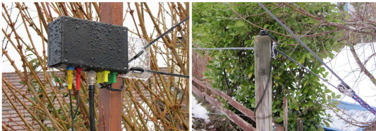
Fig. 10 : Point d'alimentation (source avec boîte d'accord) et terminaison
