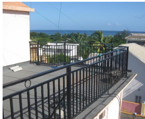
Haubanage des antennes (Océan Indien direction Nord)
